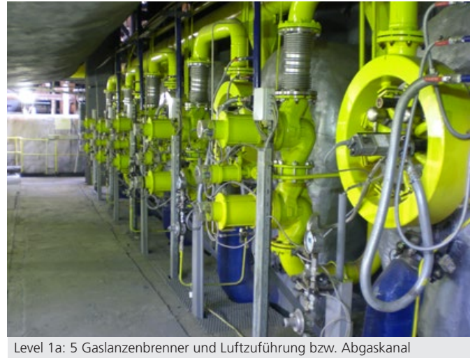
Level 1a: 5 Gaslanzenbrenner und Luftzuführung bzw. Abgaskanal
