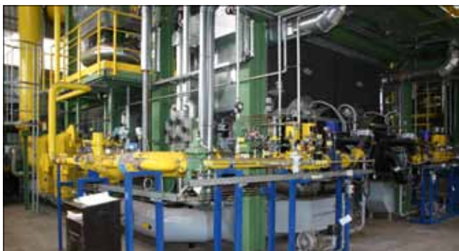
ArcelorMittal Bremen GmbH – SAACKE realisierte das Armgas-Feuerungssystem
