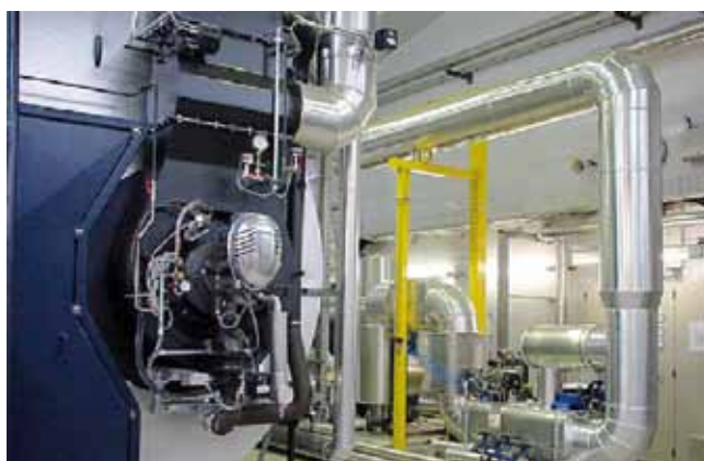
SAACKE Brenner SKV-SF bei TBA Walsdorf
